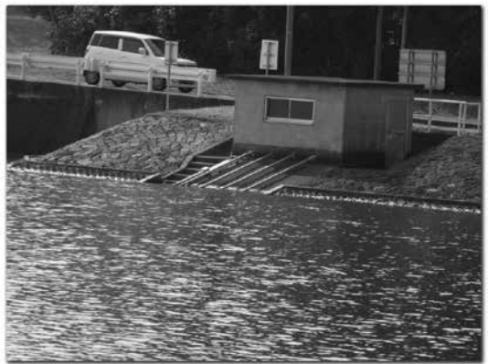
写真 26 田畑のための取水施設（三谷三郎池）
