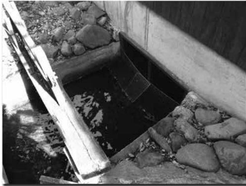
写真 14 導水路と水輪を傷めないように設置された金網の芥除け（ゴミよけ） （三鷹市大沢新車）
