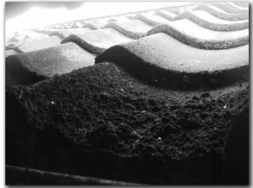
写真14 入口の瓦屋根、黒いカサカサしたものが堆積
